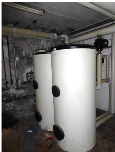
Trinkwarmwasserspeicher für Sporthalle
