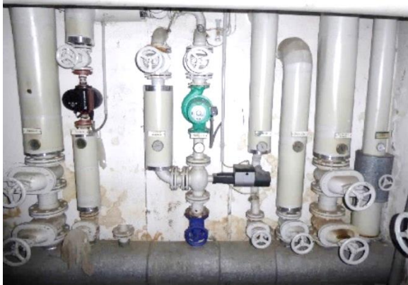
Wärmeverteilung in Heizkreise & Heizungspumpen
